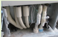
貯湯タンクユニット下
