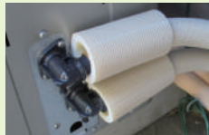
ヒートポンプ接続部
