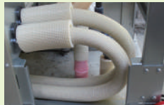
貯湯タンクユニット下
