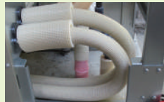
貯湯タンクユニット下
