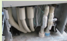
貯湯タンクユニット下
