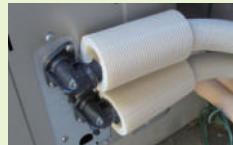
ヒートポンプ接続部
