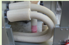
タンクユニット下
