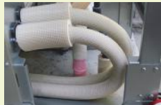
タンクユニット下
