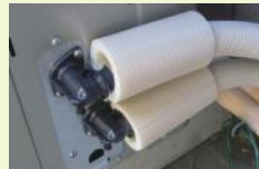
ヒートポンプ接続部
